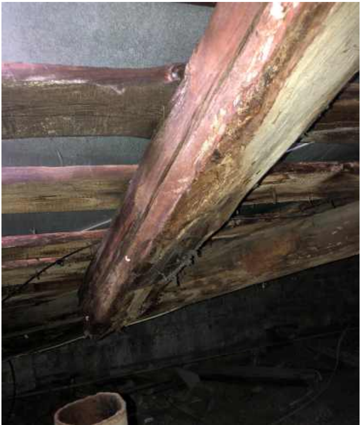
Фото №55 Замокання, пошкодження та тріщини дерев'яних конструкцій даху
