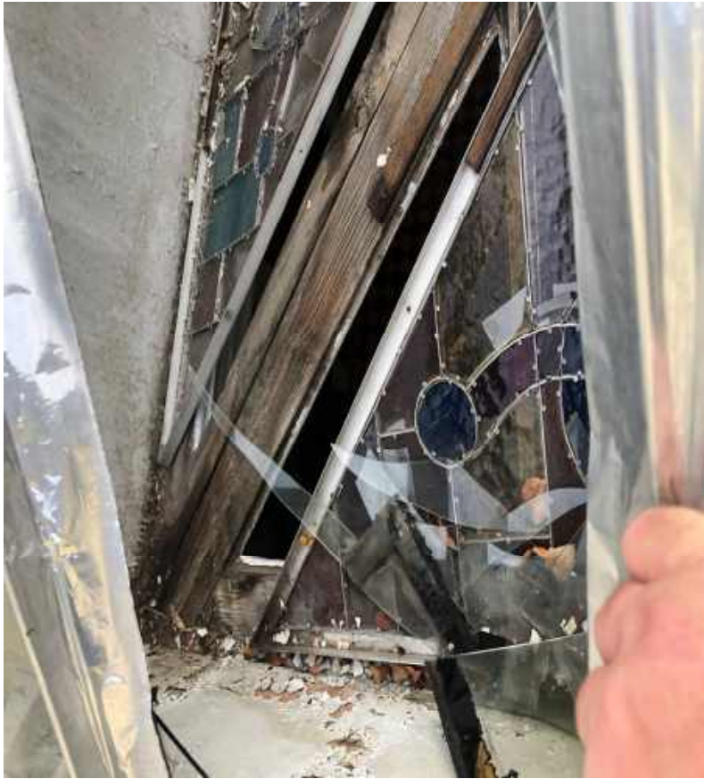
Фото №62 Замокання, пошкодження та гниття деревних конструкцій мозаїчного вітражу
