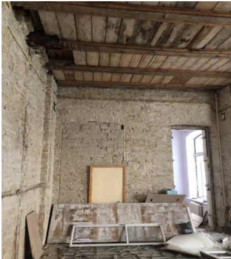
Фото №33 Замокання несучих та огорожуючих дерев'яних конструкцій перекриття
