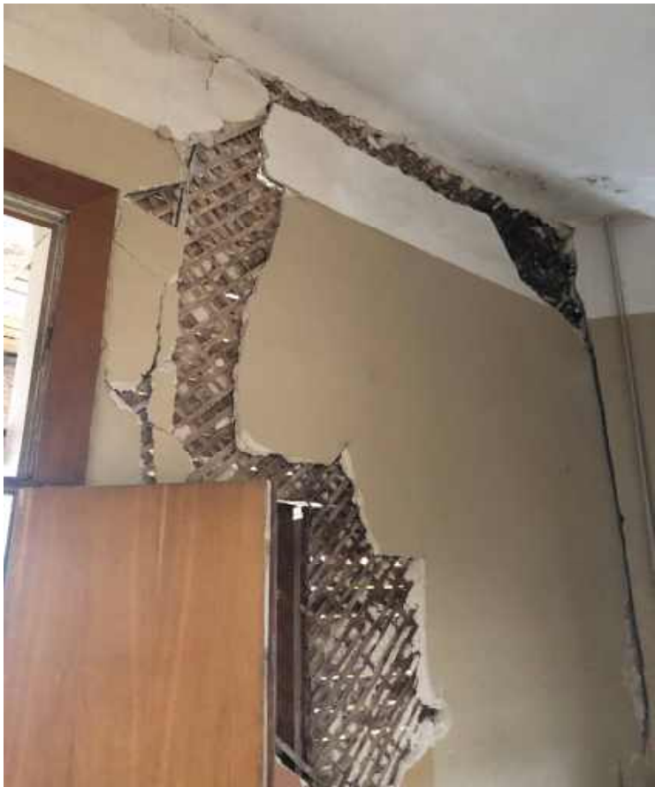
Фото №29 Пошкодження та втрати дерев'яних перегородок, в наслідок вибухової хвилі (1 пов.)
