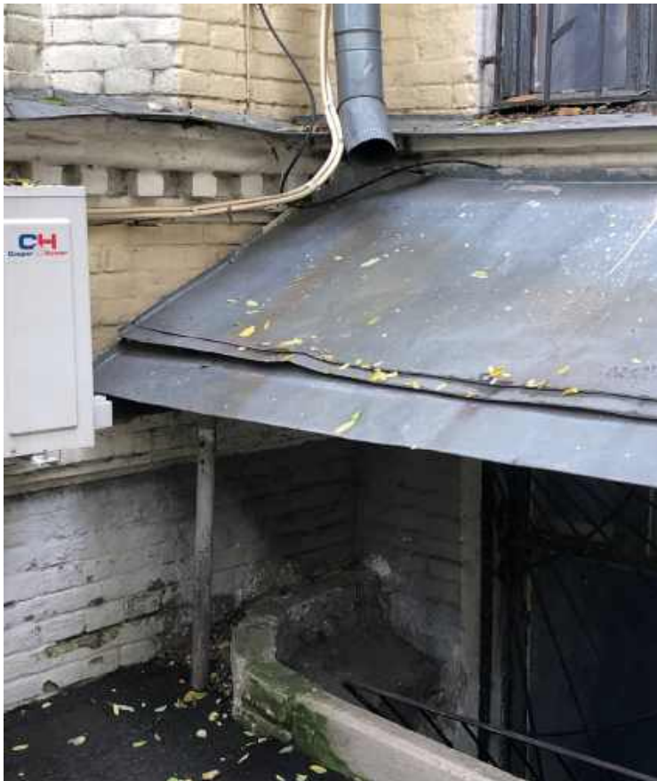
Фото №13 Замокання цокольних ділянок стін; незадовільний стан системи водовідведення
