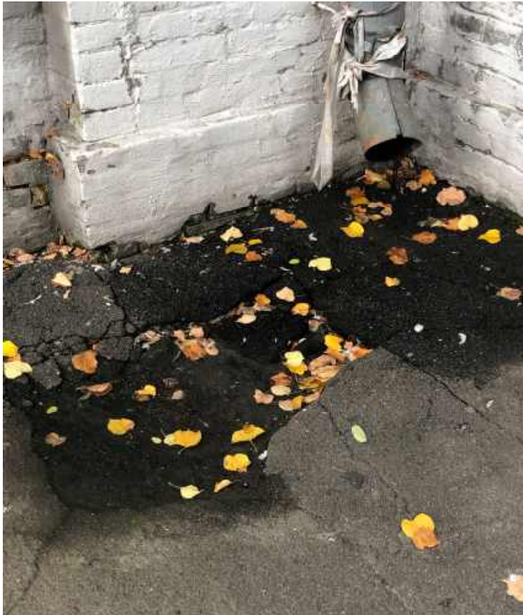
Фото №15 Від’ємний ухил та втрати мостіння; незадовільний стан системи водовідведення
