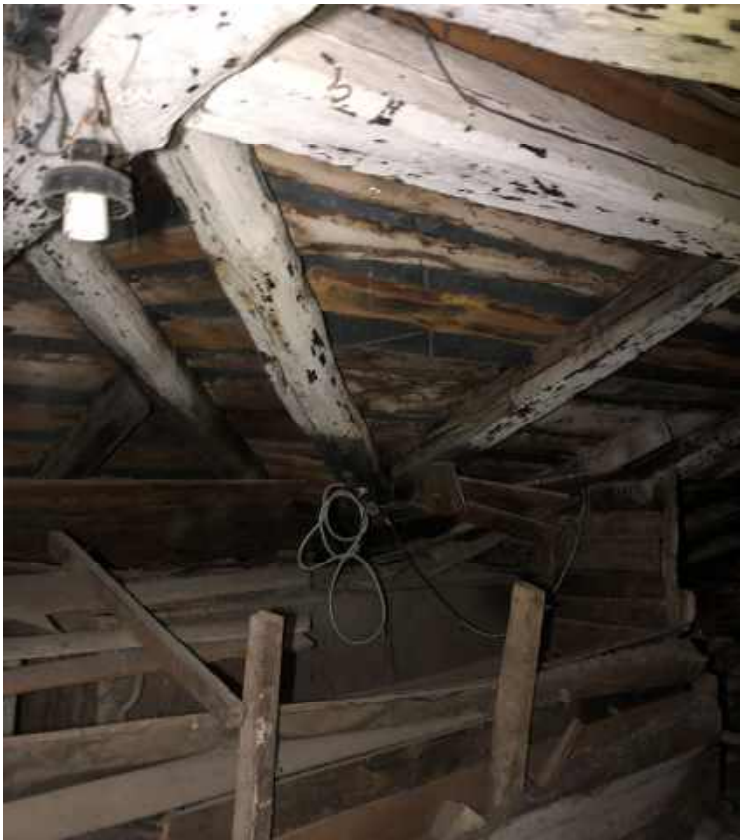
Фото №52 Замокання, пошкодження та гниття дерев’яних конструкцій кроквяної системи даху
