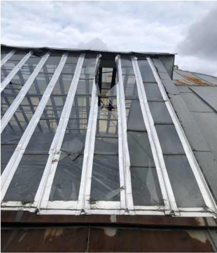
Фото №58 Втрати та пошкодження скляного заскління покриття світлового ліхтаря
