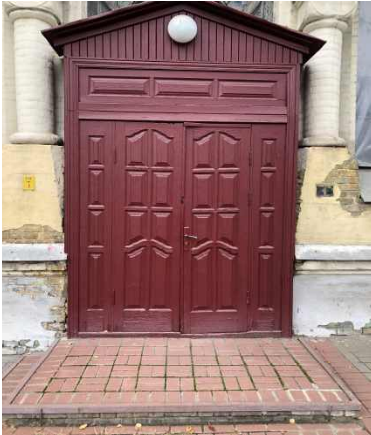
Фото №20 Загальний технічний стан центральної вхідної групи головного фасаду
