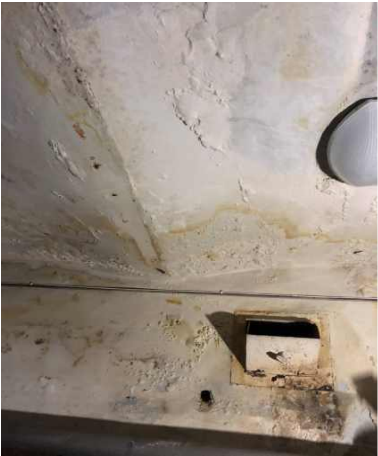
Фото №45 Підвищена вологість, деградація та втрати штукатурного оздоблення підвалу
