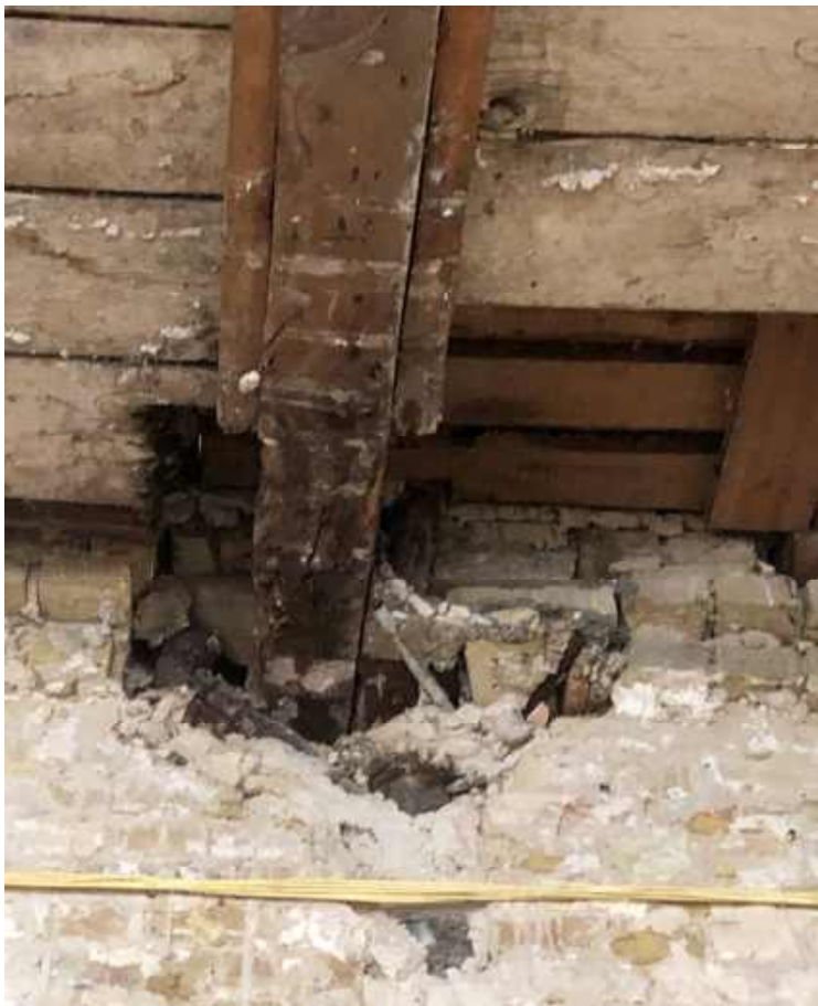
Фото №34 Втрата міцності та гниття деревини опірної частини несучої балки перекриття
