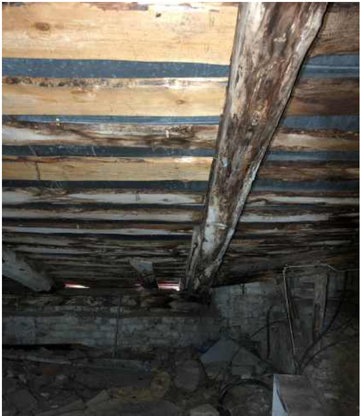
Фото №53 Замокання, пошкодження та гниття дерев'яних конструкцій кроквяної системи даху
