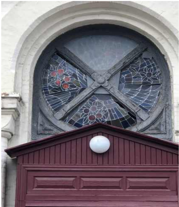
Фото №19 Пошкодження та втрати заскління мозаїчного вітражу центральної вхідної групи
