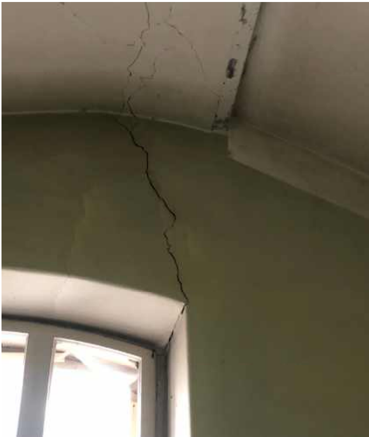
Фото №35 Наскрізні вертикальні тріщини стіни лівого торцевого фасаду ( 1 поверх)
