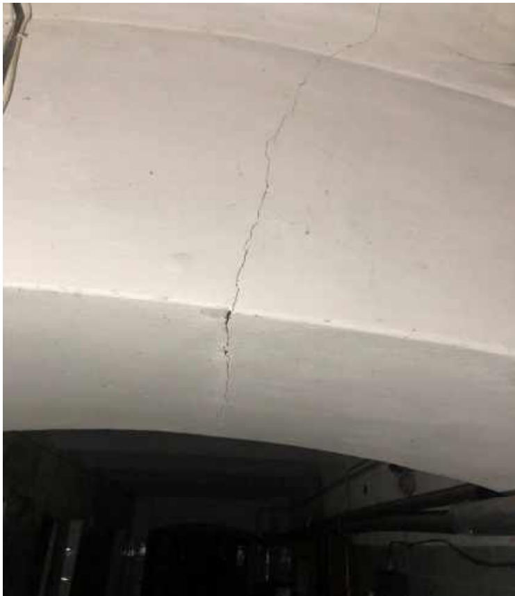
Фото №43 Тріщини цегляних стін, конструкцій їх перемичок та перекриття ( підвал)
