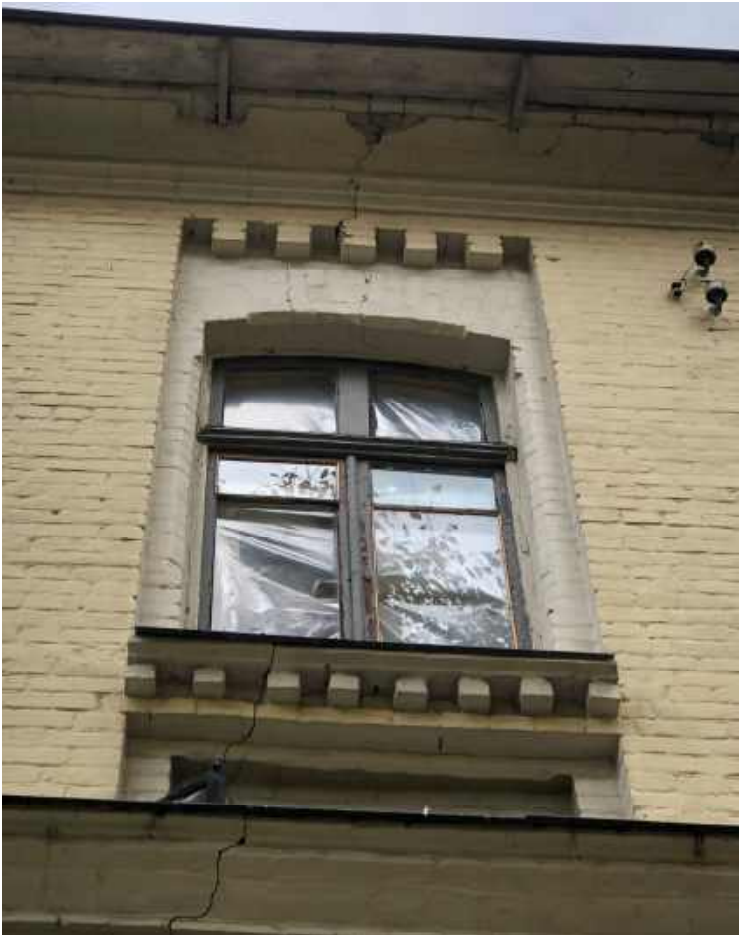
Фото №7 Наскрізна вертикальна тріщина лівого торцевого фасаду
