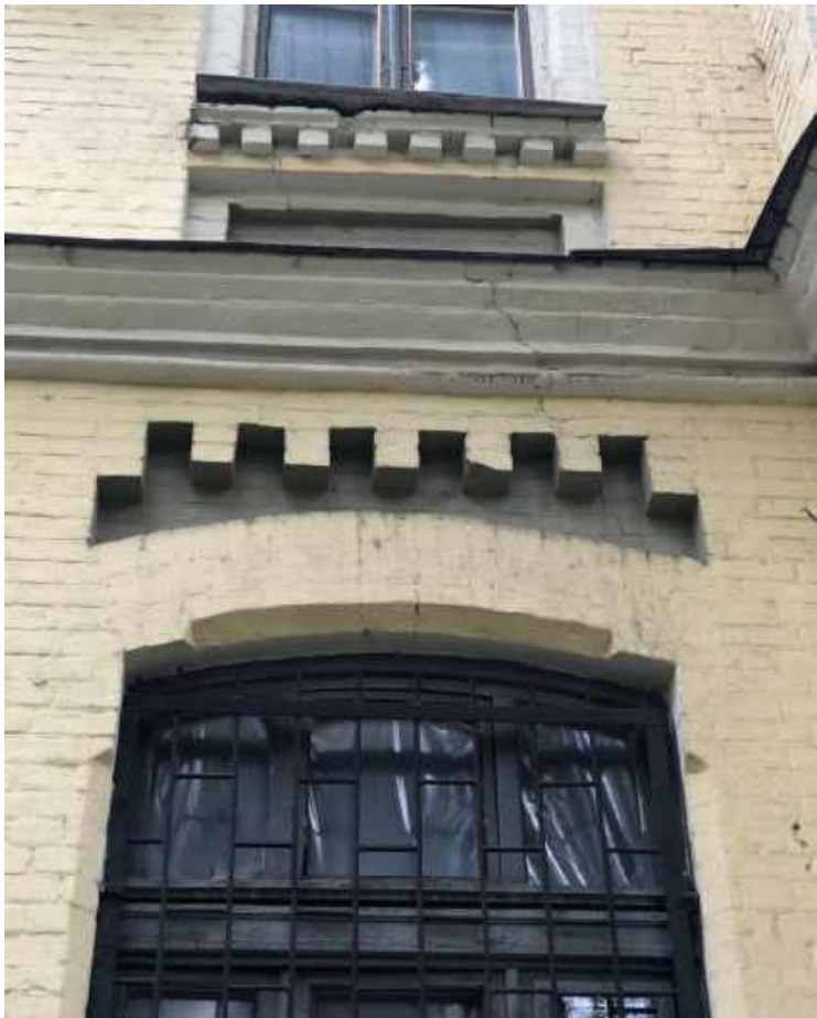
Фото №9 Тріщини перемок, міжповерхових карнизів та підвіконних ділянок фасадних стін
