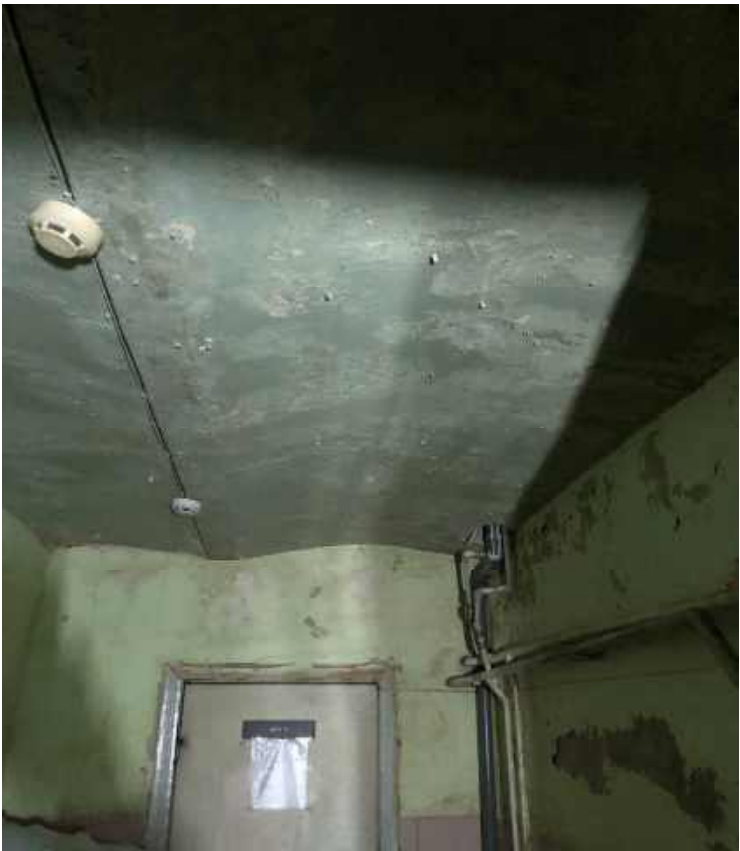
Фото №46 Підвищена вологість, деградація та втрати несучих конструкцій підвалу
