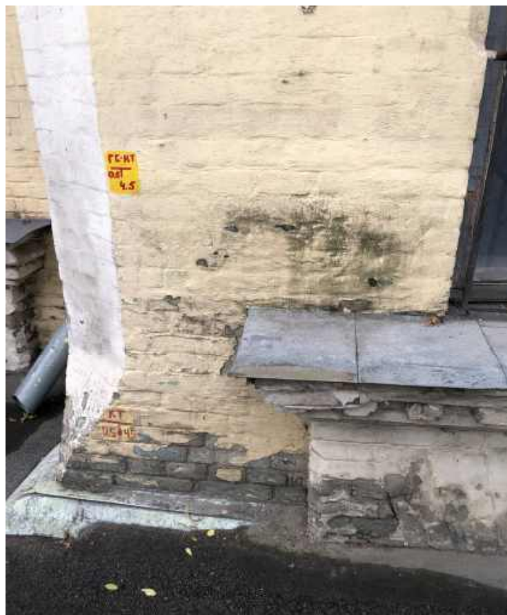
Фото №5 Замокання, підвищена вологість та втрати оздоблення цокольних ділянок стін
