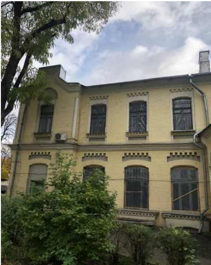
Фото №1 Втрачене заскління вікон дворового фасаду
