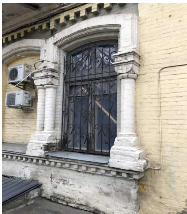
Фото №6 Замокання, підвищена вологість та втрати оздоблення цокольних ділянок стін
