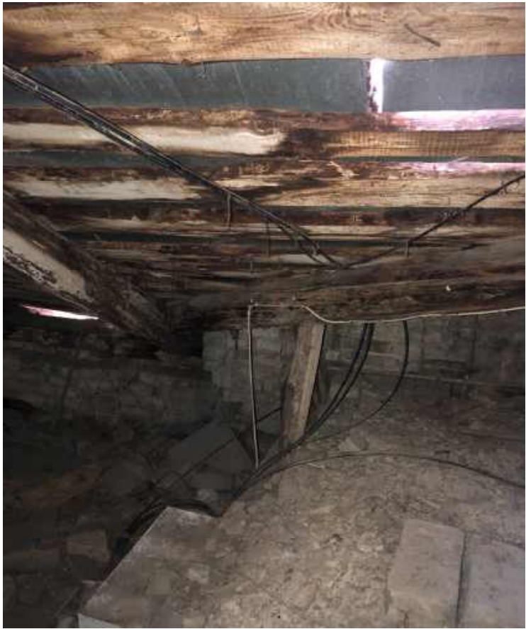
Фото №54 Замокання, пошкодження та втрати дерев'яних конструкцій кроквяної системи даху
