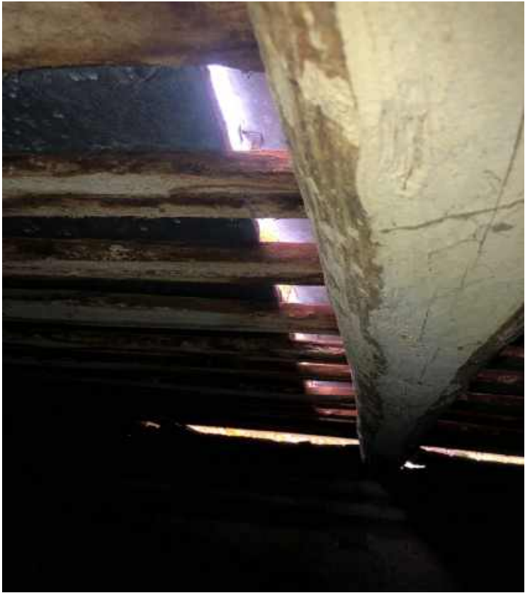
Фото №50 Зміщення та втрати цілісності дошок обрешітки; зазори по швах металевого покриття
