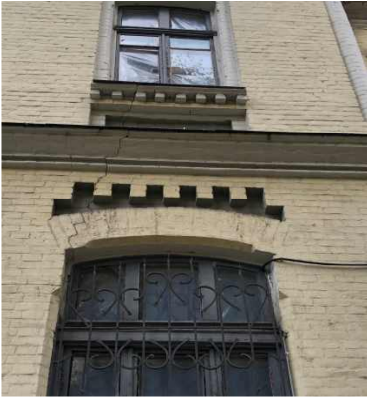
Фото №8 Наскрізна вертикальна тріщина лівого торцевого фасаду
