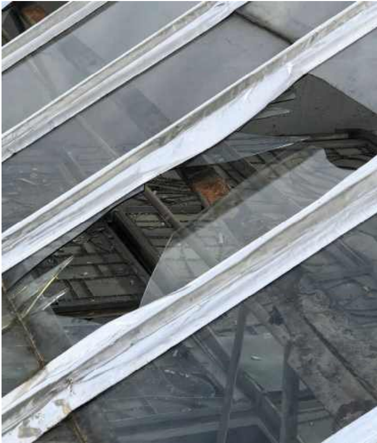
Фото №60 Корозія металевих повздовжніх прогонів несучого каркасу ліхтаря
