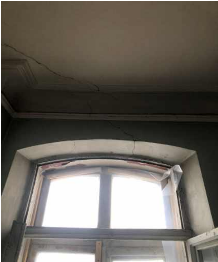
Фото №39 Наскрізні тріщини стіни та перекриття лівого торцевого фасаду ( 2 поверх)
