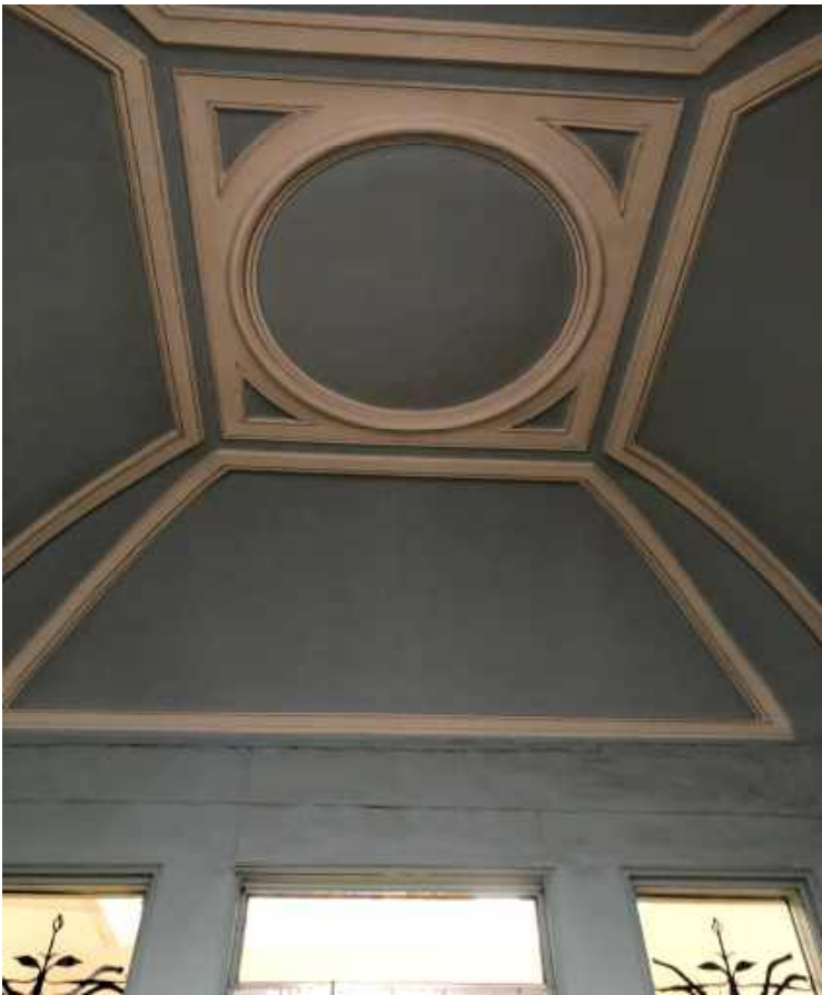
Фото №21 Загальний технічний стан конструкції стелі та перекриття центральної вхідної групи
