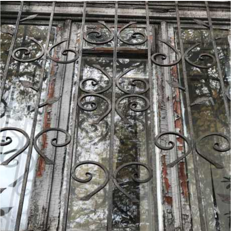
Фото №4 Втрачене заскління вікон, лушення, деструкція та втрати пофарбування рам
