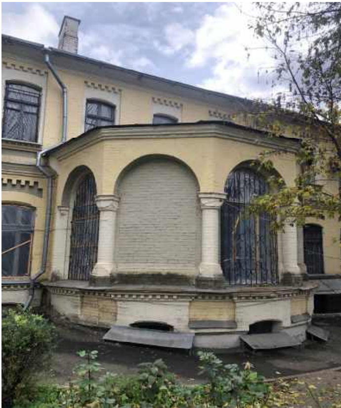
Фото №2 Втрачене заскління вікон дворового фасаду
