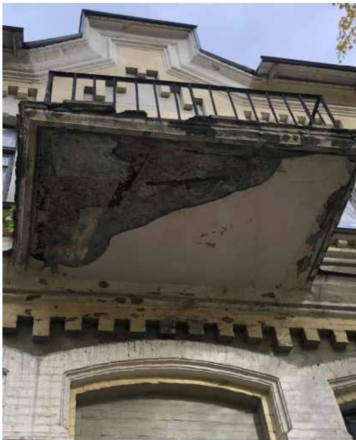
Фото №11 Втрата оздоблення, захисного шару бетону плит, корозія металевих балок балконів
