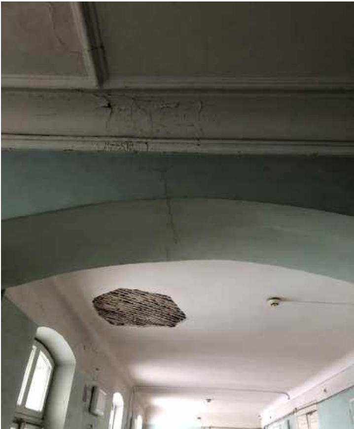
Фото №42 Замокання, втрати, тріщини та деструкція оздоблення стін та перекриття ( 2 поверх)
