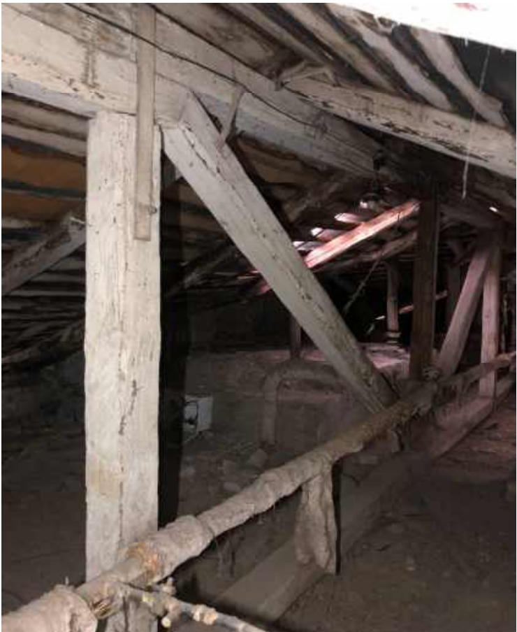
Фото №51 Замокання, пошкодження та втрати дерев’яних конструкцій кроквяної системи даху
