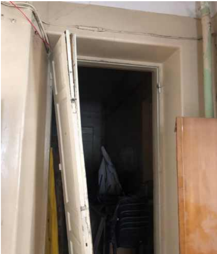
Фото №28 Втрати та пошкодження дверних заповнень приміщень першого поверху
