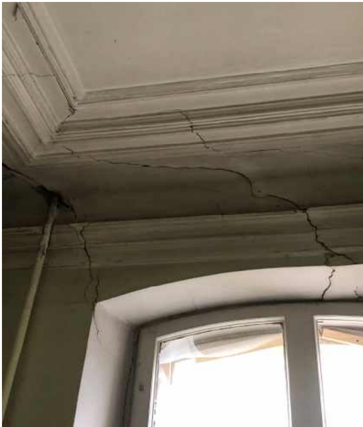
Фото №36 Наскрізні тріщини стіни та перекриття лівого торцевого фасаду ( 1 поверх)
