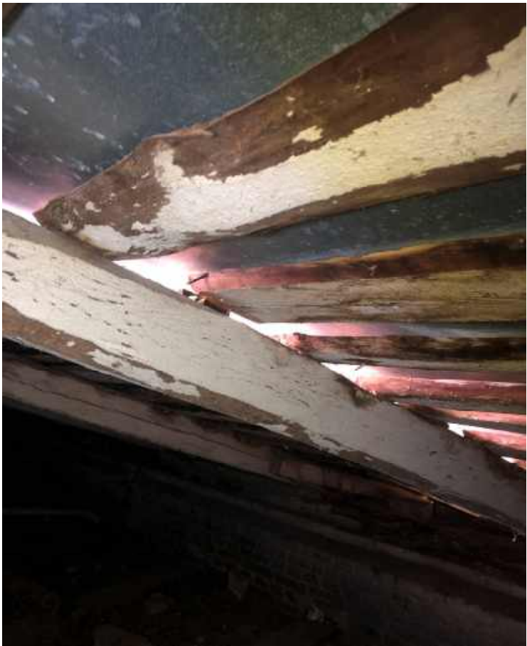
Фото №49 Зміщення та втрати цілісності дошок обрешітки; зазори по швах металевого покриття
