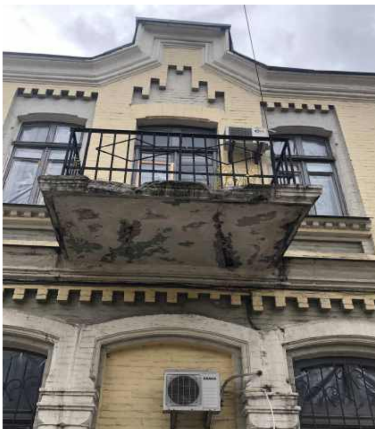
Фото №12 Втрати оздоблення, захисного шару бетону плит, корозія металевих балок балконів
