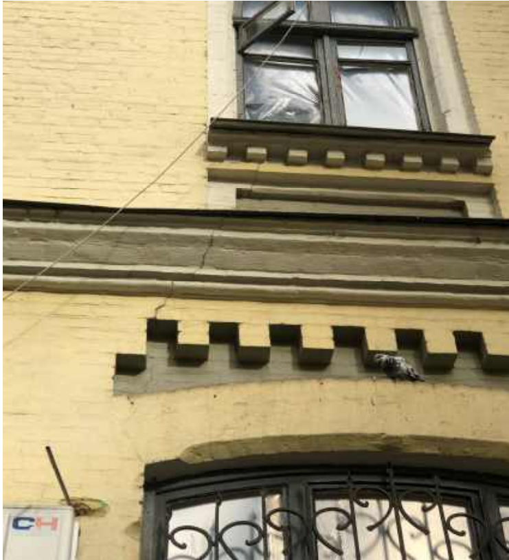
Фото №10 Тріщини перемок, міжповерхових карнизів та підвіконних ділянок фасадних стін
