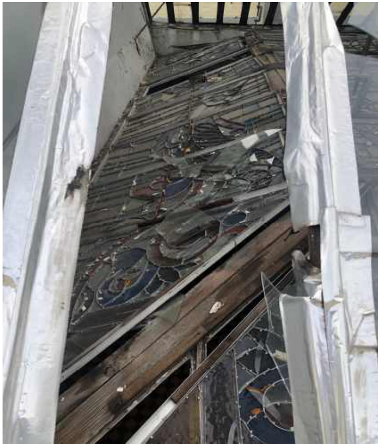
Фото №61 Замокання, пошкодження та гниття деревних конструкцій мозаїчного вітражу
