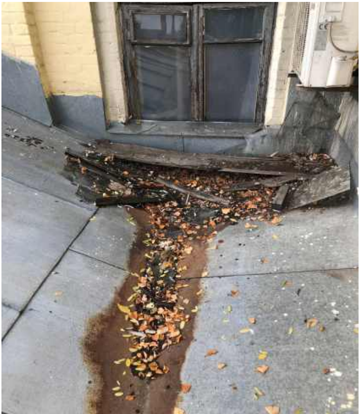
Фото №56 Незадовільний стан та захаращеність водозбірних лотків даху, корозія покриття
