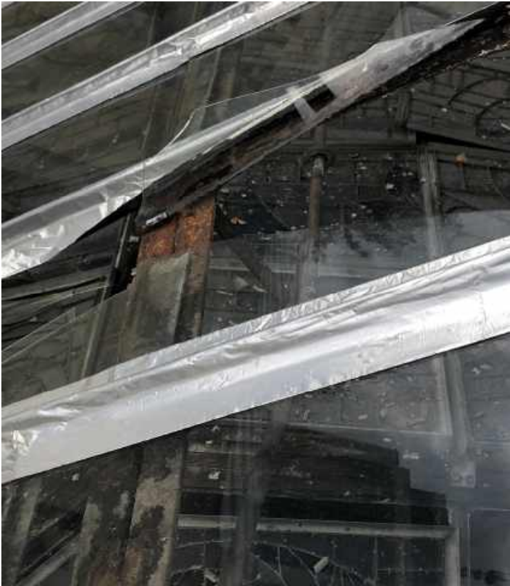
Фото №59 Корозія металевих повздовжніх прогонів несучого каркасу ліхтаря
