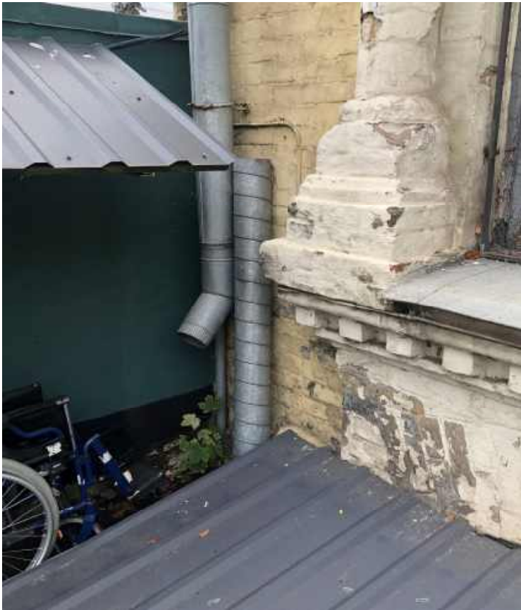
Фото №16 Незадовільний стан системи водовідведення; втрати та замокання цоколя стін
