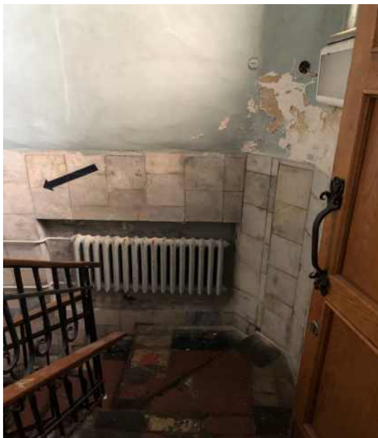
Фото №24 Пошкодження, втрати, стертя та тріщини головного сходового маршу до підвалу
