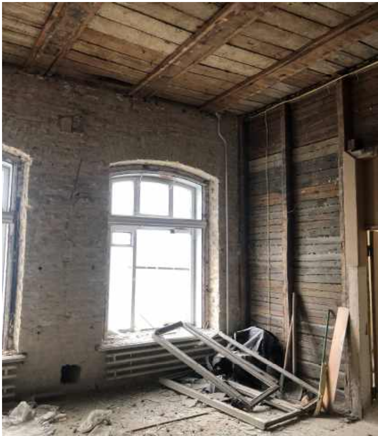
Фото №32 Загальний технічний стан незавершених ремонтних робіт перекриття та стін
