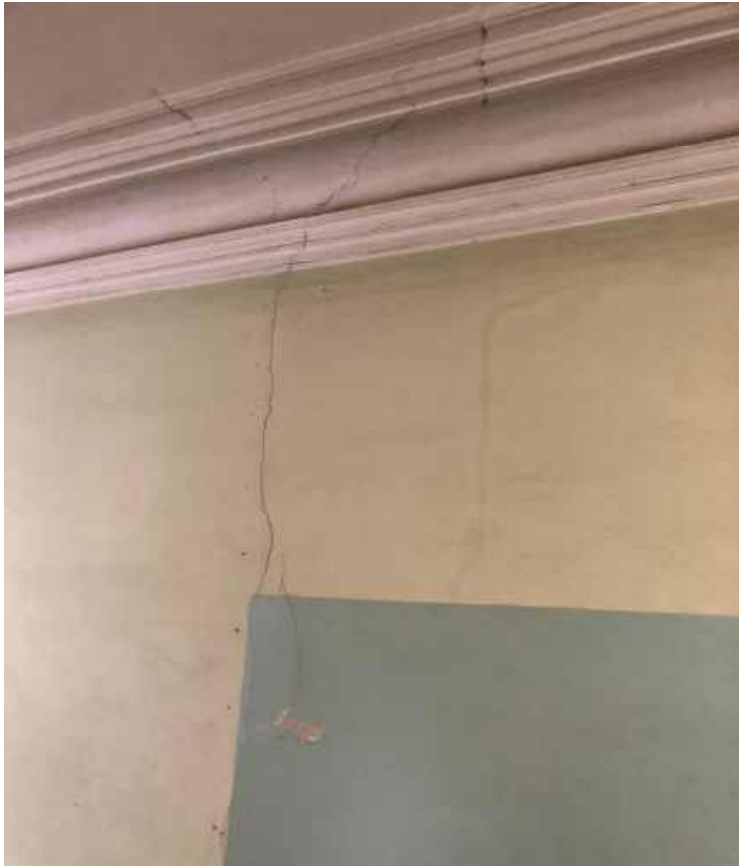
Фото №37 Наскрізні тріщини стіни та перекриття сходової клітини торцевого фасаду ( 1 поверх)
