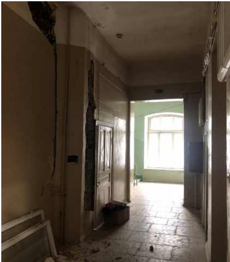
Фото №30 Пошкодження та втрати дерев'яних перегородок та стін, в наслідок вибухової хвилі
