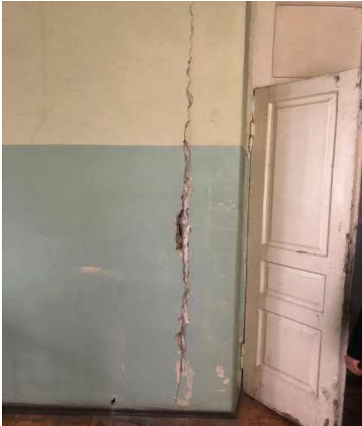
Фото №38 Наскрізні вертикальні тріщини стіни сходової клітини торцевого фасаду ( 1 поверх)
