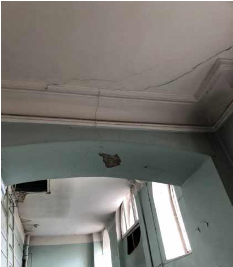
Фото №40 Наскрізні тріщини перемички та перекриття лівого торцевого фасаду ( 2 поверх)
