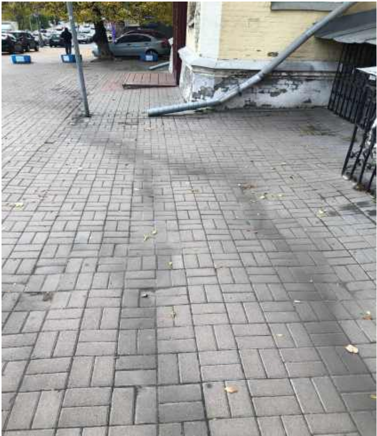
Фото №18 Значне просідання окремих ділянок мостіння та недосконале планування території
