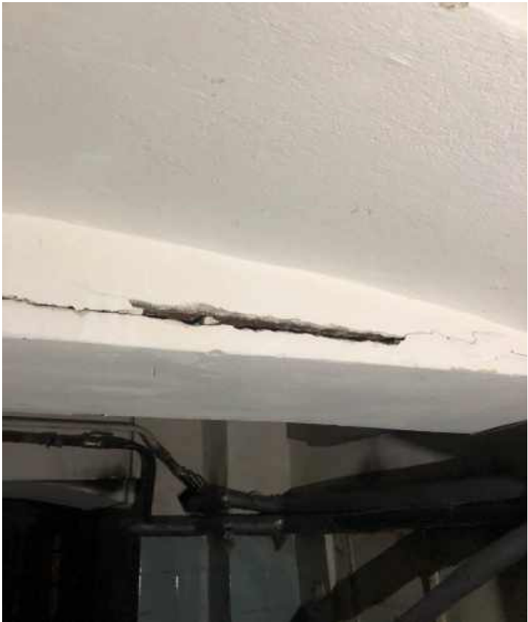
Фото №44 Тріщини та втрати перемички стіни, корозія металевих балок перекриття
