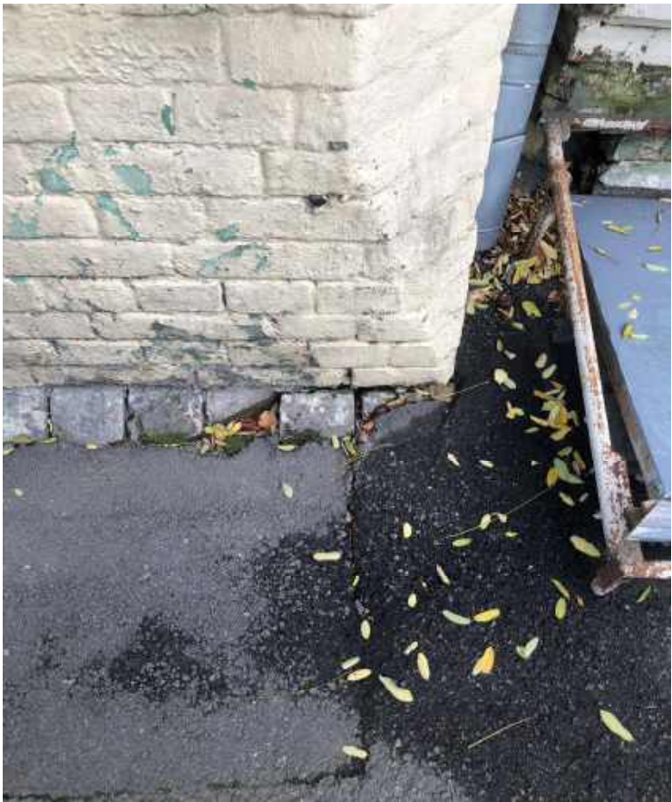
Фото №17 Незадовільний стан системи водовідведення; втрати та тріщини мостіння
