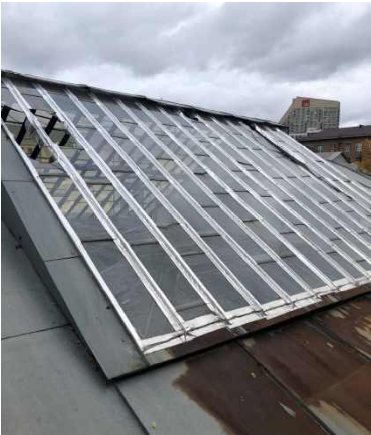
Фото №57 Втрати та пошкодження скляного заскління покриття світлового ліхтаря
