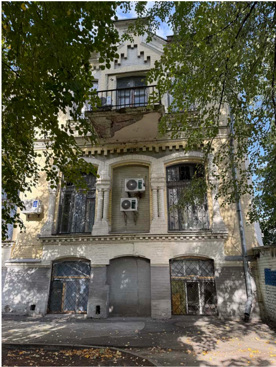
10. Права частина південного фасаду. Видно руйнування на плиті балкону. Всі вікна на фасаді пошкоджені.
