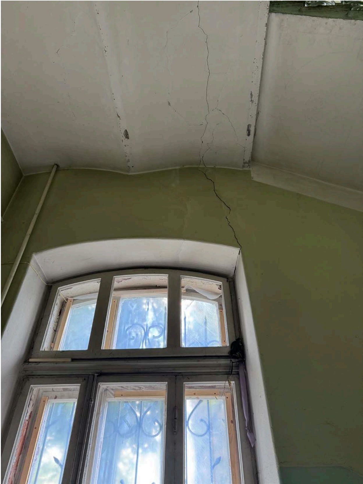
22. Тріщини в стінах та в сходовій площадці. Сходи 2. Рівень першого поверху.
