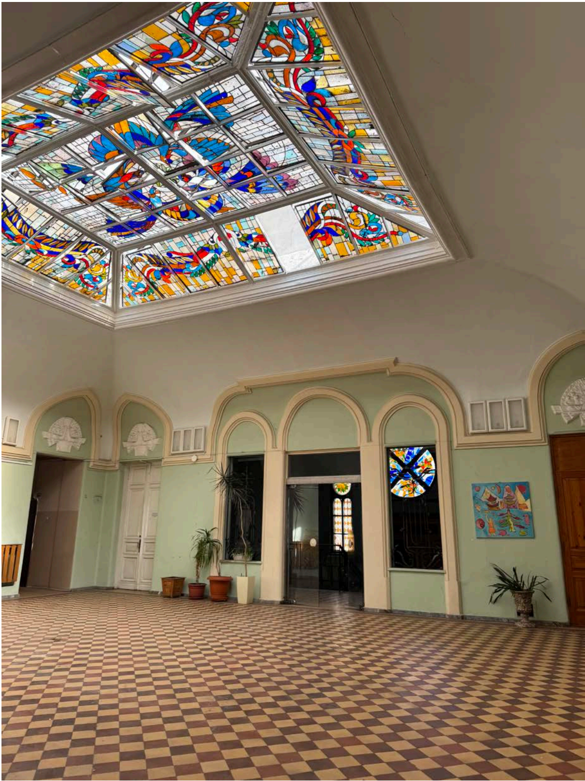
18. Бачимо пошкодження вітражу світлового ліхтаря.
