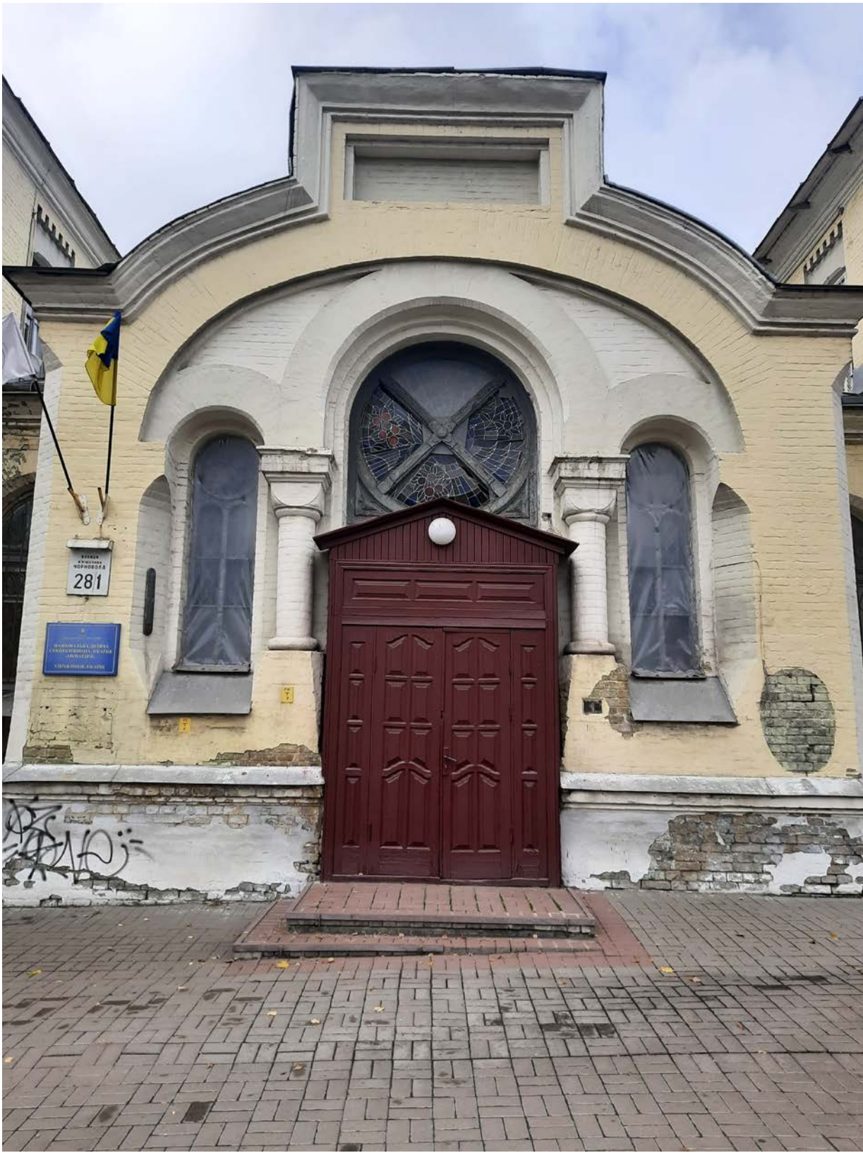
3. Східний фасад. Центральна частина - головний вхід. Пошкодження фарбового шару розширюють уяву про мурування. Десонуюче рішення вхідного тамбура провакує бажання скоріш все переробити.
