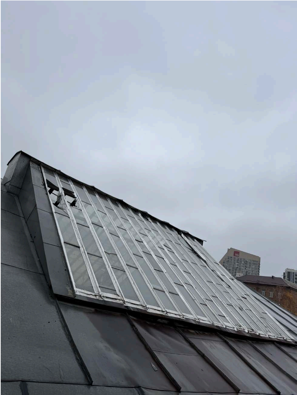
11. Світловий ліхтар центрального холу має пошкодження скла.
