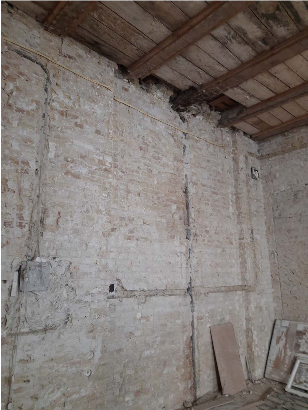
20. Приміщення 118. Незадовільний стан балок перекриття, особливо в місцях спирання.
