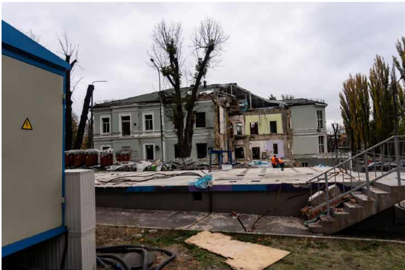
Повне руйнування частини будівлі
