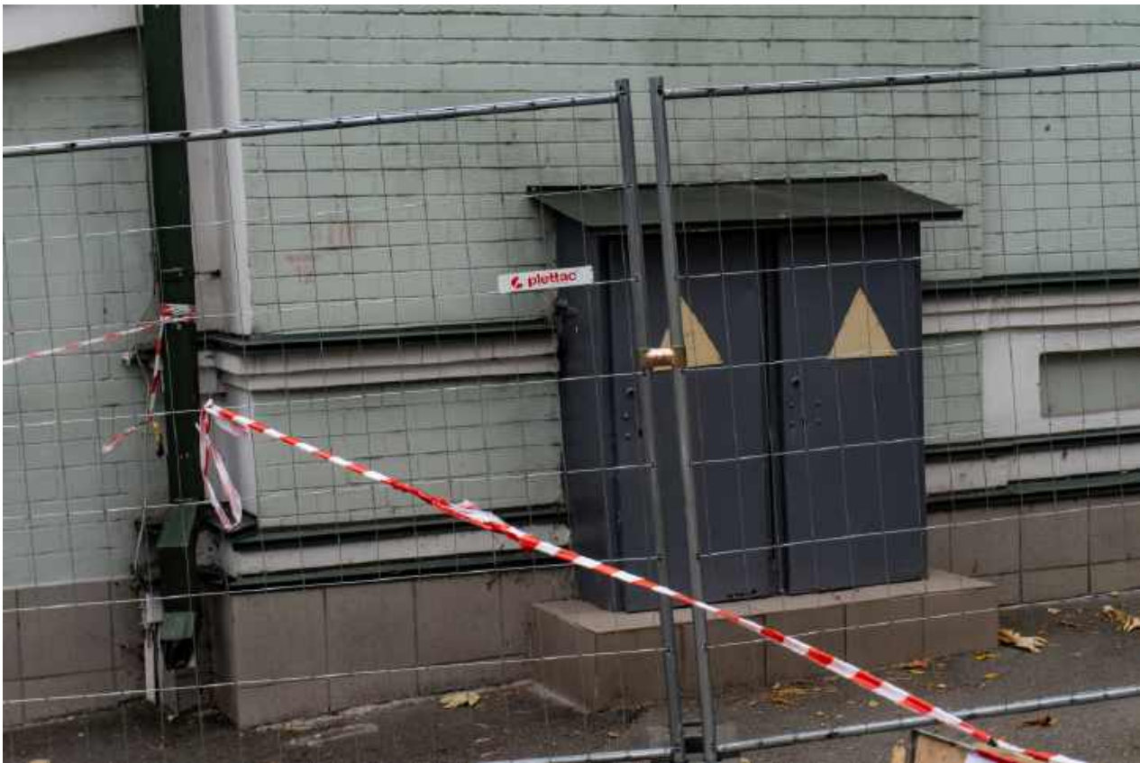
Електротехнічне обладнання (електрошафи)
