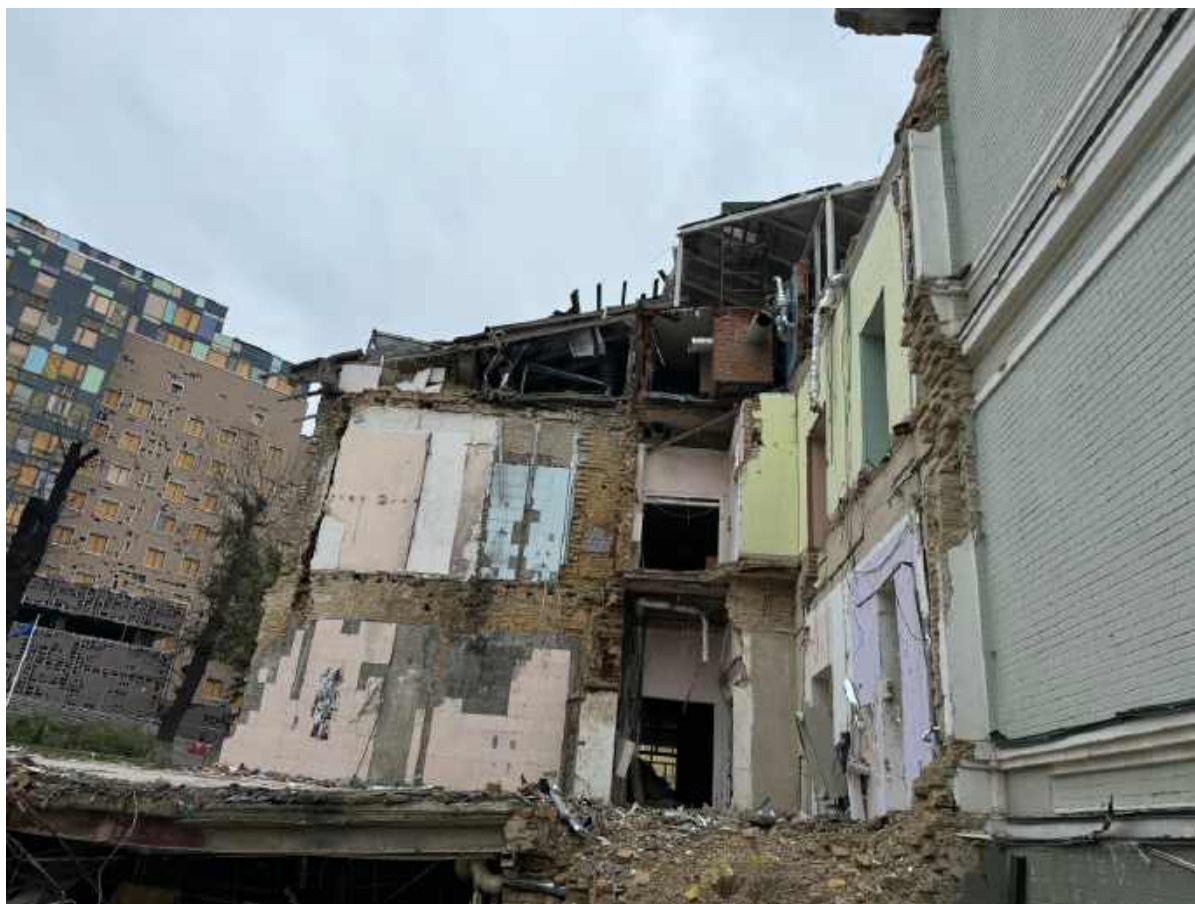
Повне руйнування частини будівлі. Порушення цілісності цегляної кладки стіни.
