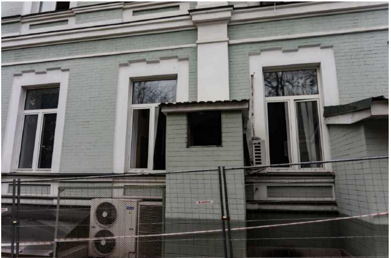
Вертикальні тріщини в оздобленні фасаду. Руїнування вікон
