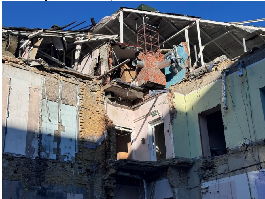
Фото 24. Фрагменти інженерних мереж на даху. Частина покрівлі з конструкціями даху відсутня повністю
