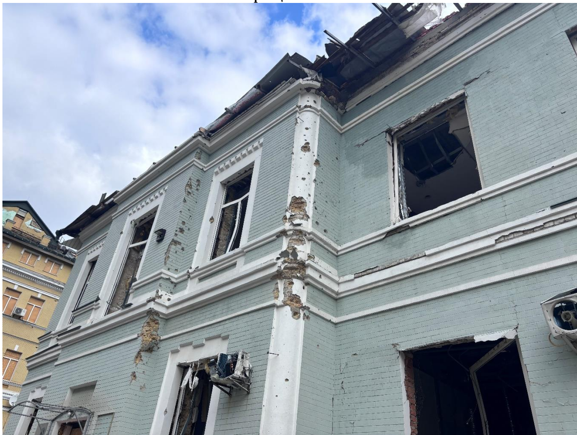
Фото 10. Фасадна площа посічена уламками
