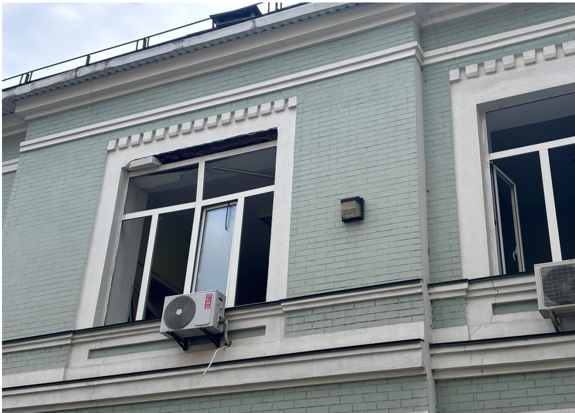
Фото 9. Втрата верхньої ділянки обрамлення вікна. Оздоблення пронизане тріщинами
