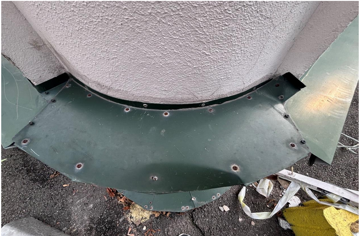
Фото 12. Розгерметизація стиків металевих захисних накривок, «вихід» елементів з гнізд їх кріплення до стін
