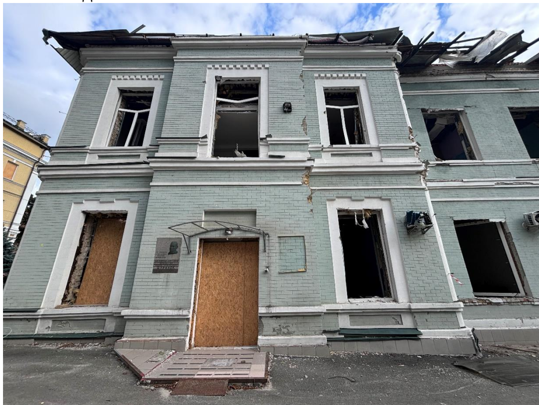
Фото 14. Віконний та дверний проріз заколочений OSB плитою
