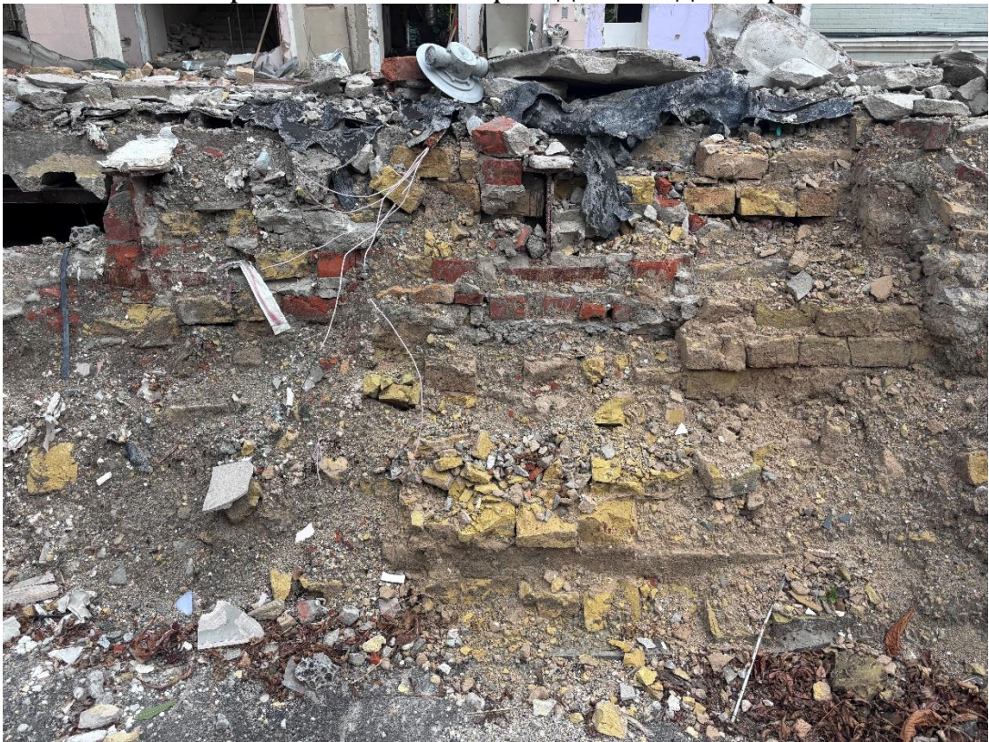
Фото 4. Домішок червоної цегли в муруванні стіни під улаштованим новим з/б перекриттям над підвалом
