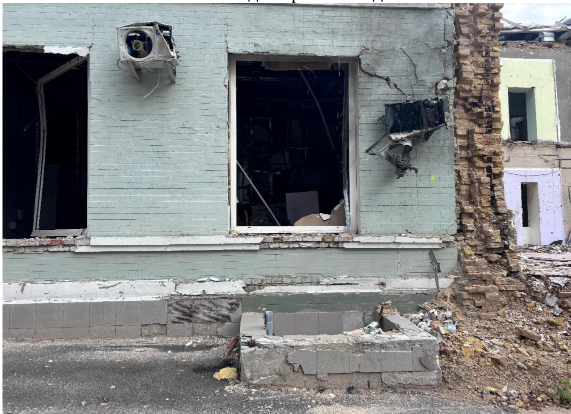
Фото 13. Зовнішні блоки кондиціонерів розплавлені
