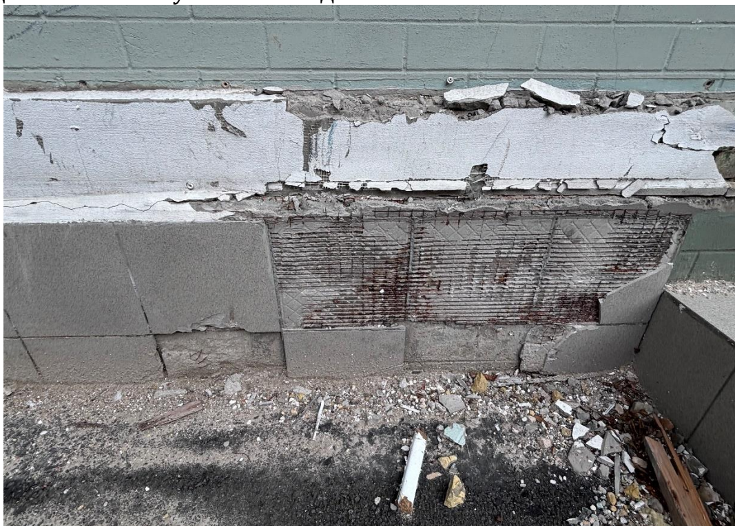
Фото 15. Втрата облицювання цоколю до відкриття іржавої металевої сітки. Цокольний пояс частково посічений уламками
