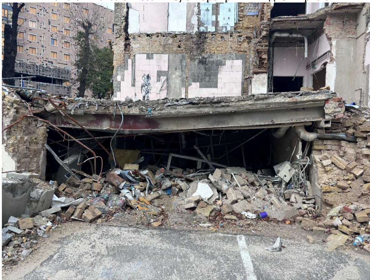
Фото 7. Прогин з/б перекриття пд.-зх. крила на ділянці прямого влучання ракети
