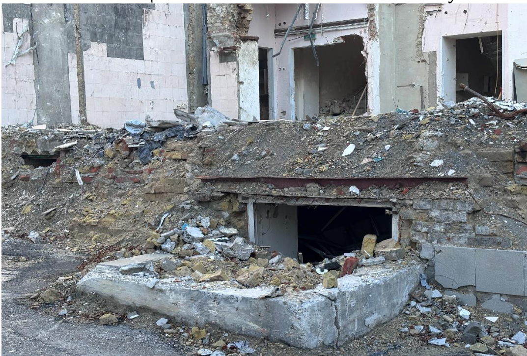
Фото 16. Втрата накривки приямку. Бетонні стінки приямку розтріскані
