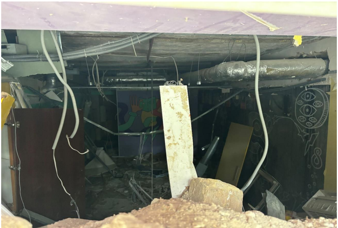
Фото 20. Загальний вигляд підвалу пд.-зх. крила після влучання ракети
