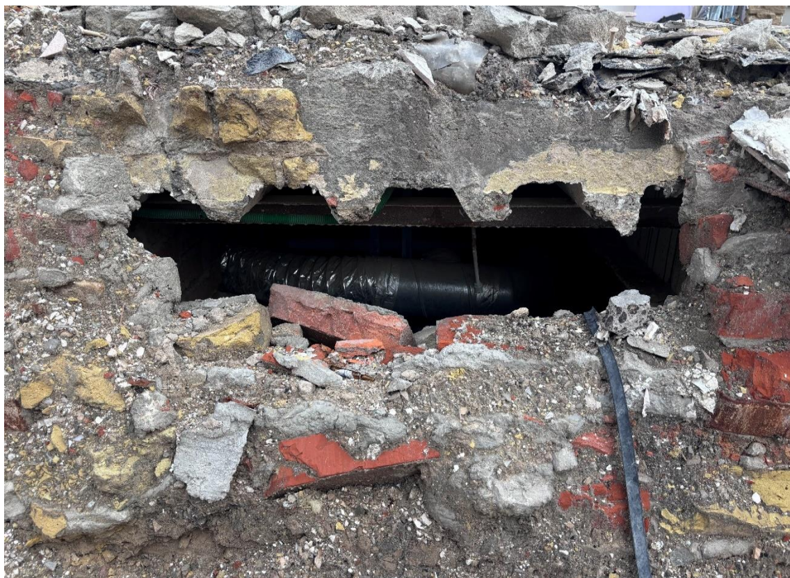
Фото 5. Фрагмент оновленого з/б перекриття . В муруванні зустрічається радянська червона цегла на цементному розчині
